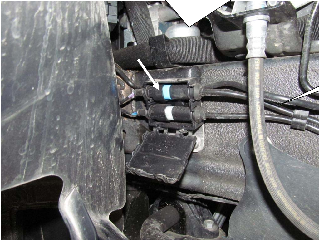
Zuleitung zum Dämpfer Line to the damper
